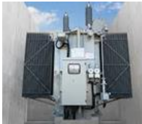
Figura 22 - Exemplo de Transformador a óleo
