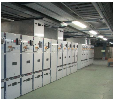
Figura 24 - Exemplo de Quadro de MT
