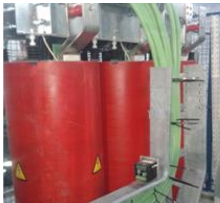
Figura 23 - Exemplo de Transformador a seco
